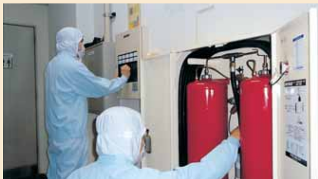
消防用設備の点検、及び工場内の安全パトロールを実施しています。常に危険な所はないかチェックしています。
