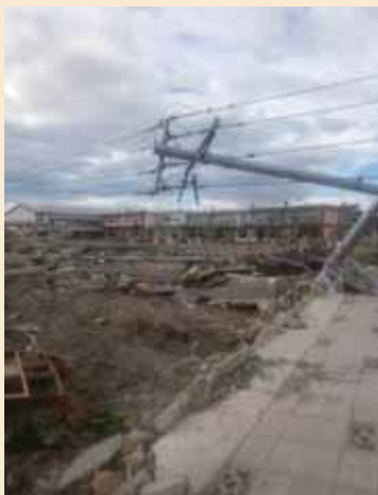
暴風により折れた電柱
