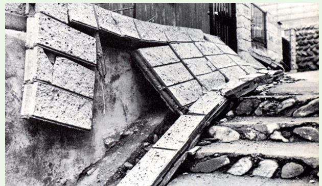
図5 1978年宮城県沖地震によるブロック塀の倒壊 (仙台市「'78宮城県沖地震災害の記録」より)
